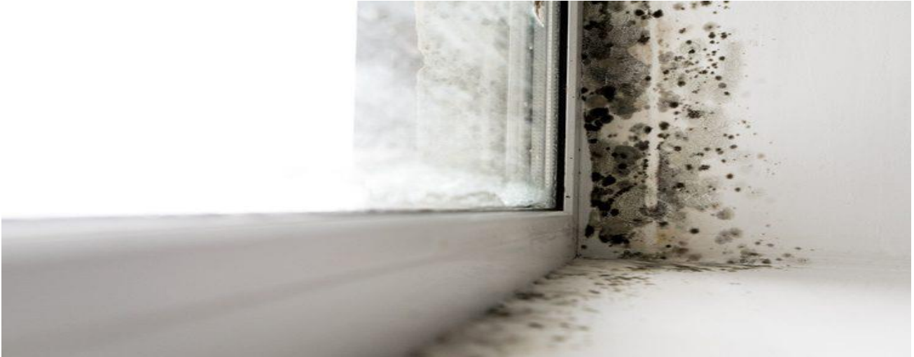
Fig. n. 1.3.1: Condensa e muffa che si forma sul muro a causa delle basse temperature superficiali dovute alle continue infiltrazioni d'aria e alla mancanza di isolamento termico del vano serramento.
