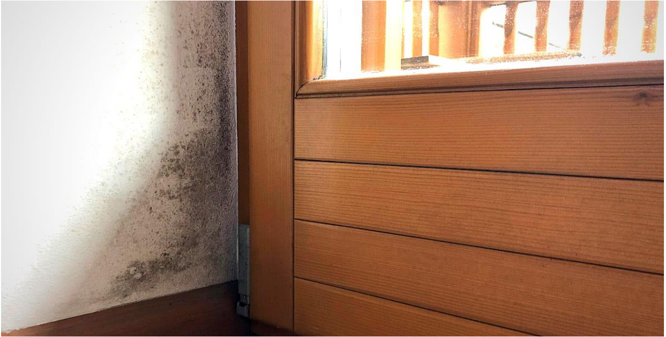
Fig. 2.2: condensa e muffa sul perimetro del foro finestra a causa dell'installazione del controllo metallico.
