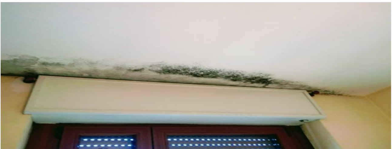
Fig. 2.3: Esempio di condensa e di muffa che si forma sul soffitto a causa di un cassonetto non adeguatamente coibentato da un punto di vista termico.
