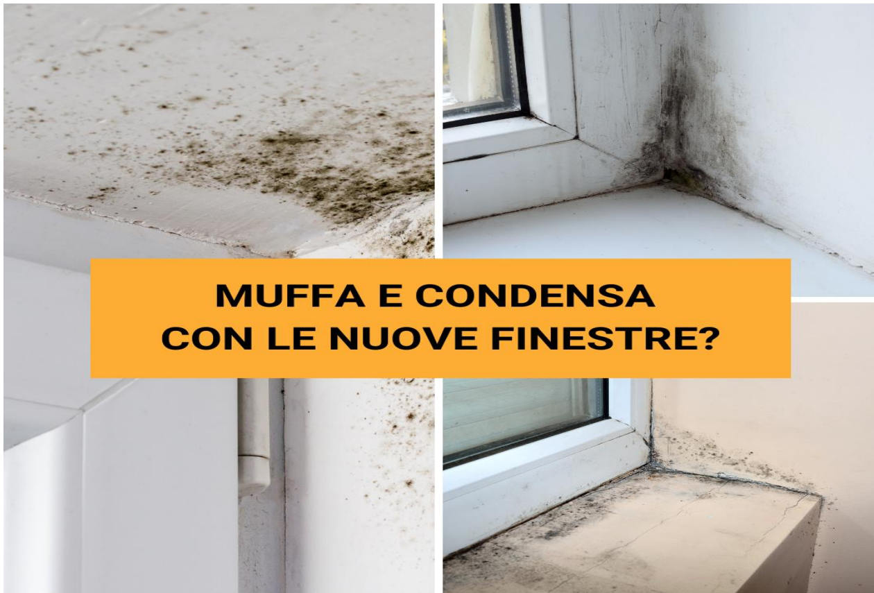
Fig. 2.1: gli effetti derivanti dal mancato isolamento del foro finestra a seguito della posa dei nuovi serramenti.
